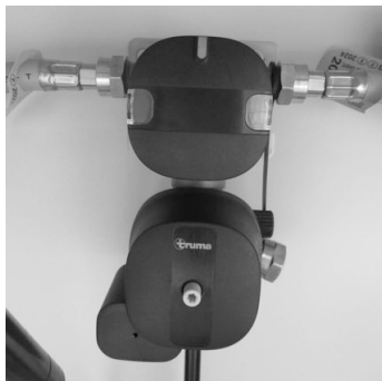
Fig. 89: Gasanlæg (med Eis-Ex og fjernvisning)
