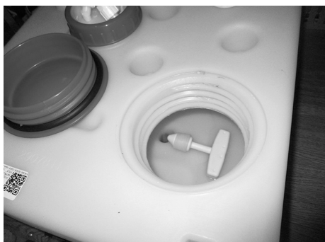
Fig. 108: Bundprop i drikkevandstanken
