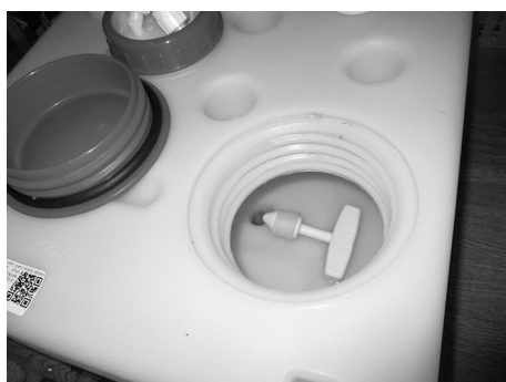
Fig. 101: Bundprop i drikkevandstanken
