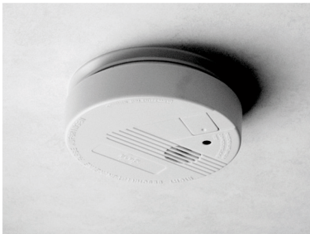
Fig. 59: Détecteur de fumée
